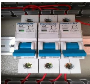
Figure 2.12 Miniatur Circuit Breaker (MCB)
